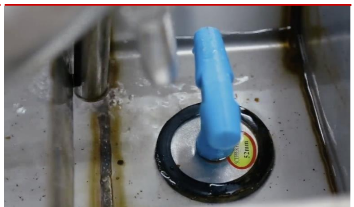
图 13 饮水采用先进节水器节水设备
