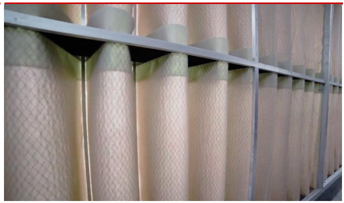
图 21 猪舍空气过滤装置
