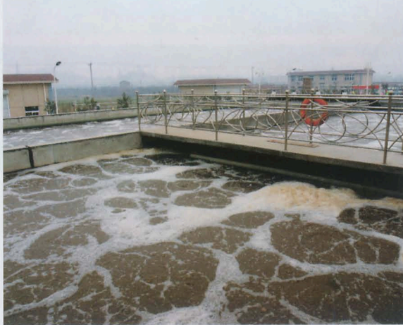
徐州的三八污水处理厂是京杭大运河线较大的污水处理厂。专家认为,东线治污的关键是确立污水处理建设和运营的新机制。
